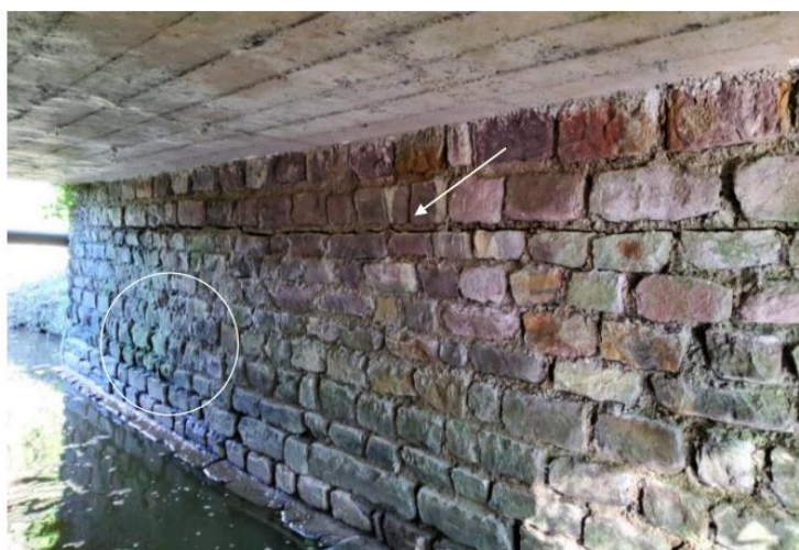
Fracture horizontale en tête du mur de front de la culée rive droite
